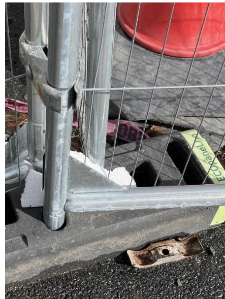
Bilde 18 viser rusten metallbit på utsiden av byggegjerdet som stammer fra selve gjerdet.
