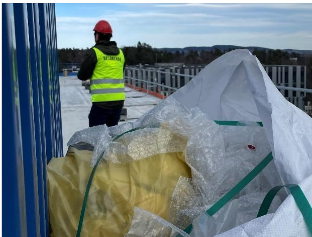
Bilde 1 viser sekk der plastavfall er mellomlagret. Sekken er mellomlagret under åpen himmel i høyden, og plastavfall kan havne på avveier om ikke sekken er tilstrekkelig sikret og lukket.
